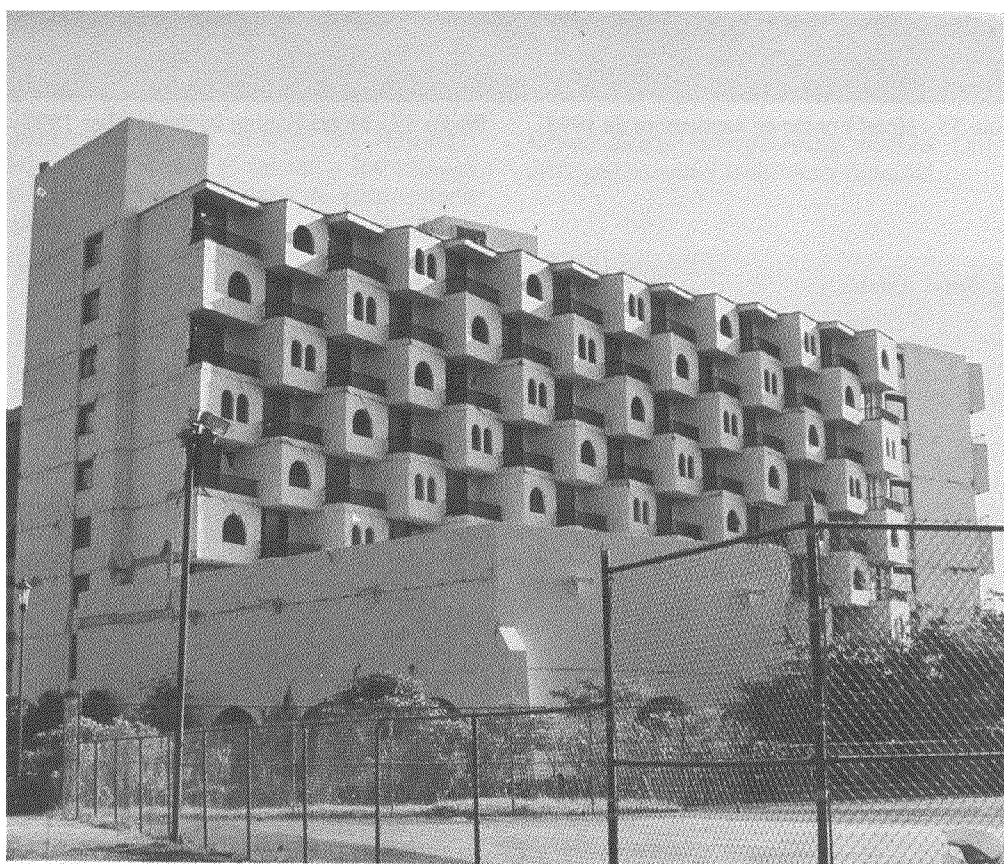
Foto 54.- Hotel Aristos después de los sismos de 1985 [1].
