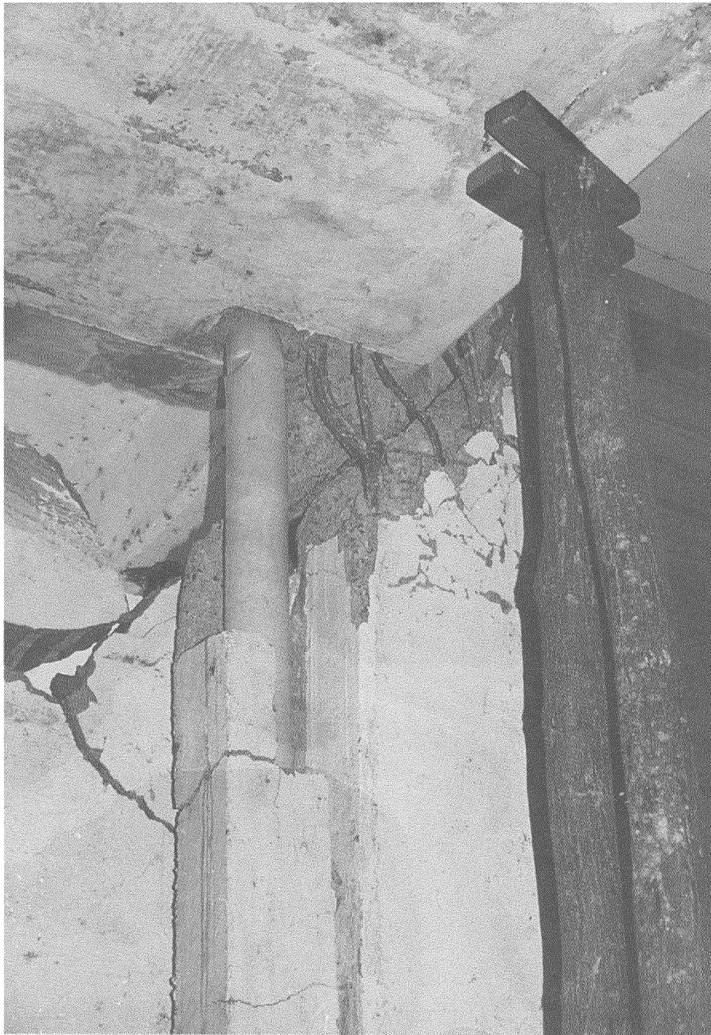
Foto 67.- Falla por cortante en la parte superior de la columna localizada en los ejes B-5 de la Fig. 6 [1]
