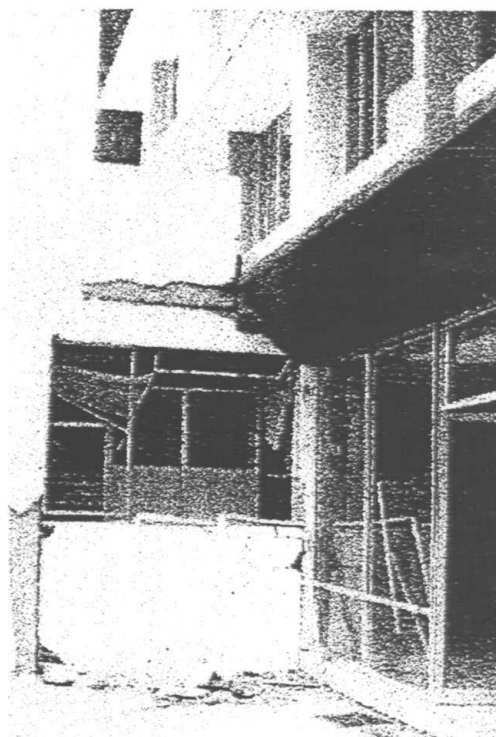
Hospital de Bahía: Daños en los elementos contruados en la junta entre el bloque principal de 5 pisos y el bloque de Consulta Externa de 1. Ref. 1
