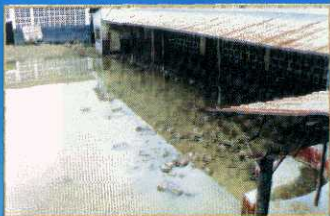
MAL DRENAJE DE PATIOS Y ÁREAS VERDES
