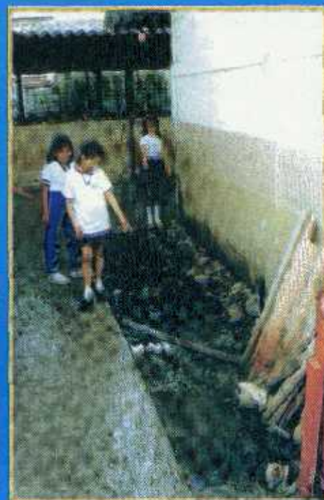
LAS INSTALACIONES SANITARIAS Y DE AGUA POTABLE
