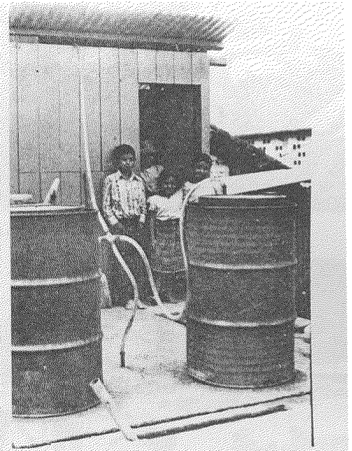
4.2 - GASÓMETRO DE LA LETRINA ANAEROBICA
