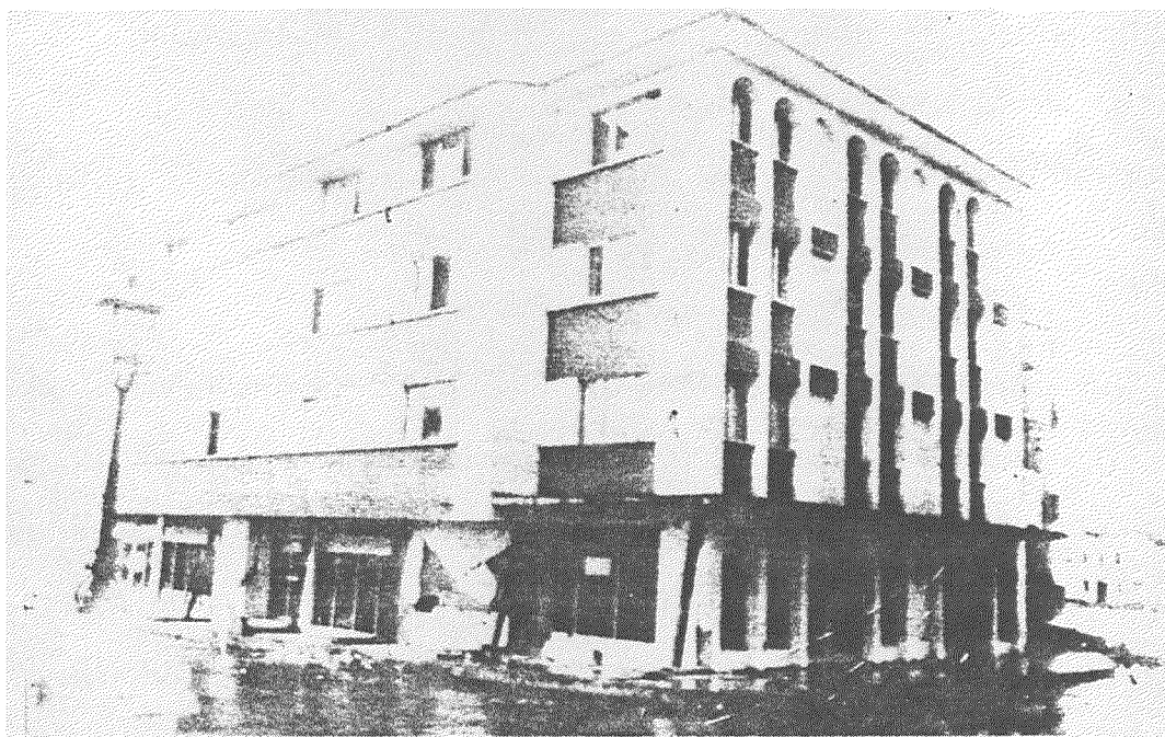
Foto 7.- Edificación de 4 plantas parcialmente colapsada durante el terremoto de Popayán debido a efectos torsionales y de fachada abierta en planta baja, ocasionando el desplazamiento y torsión de la P.B.(foto Salvatierra)
