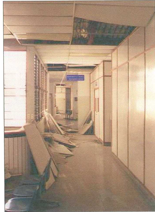
Foto 52: Daños en Cielos Falsos.
