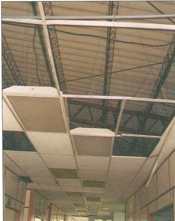
Foto 51: Daños en Cielos Falsos Ultimo Nivel.
