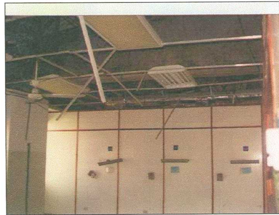
Foto 50: Daños en Cielos Falsos Ultimo Nivel.
