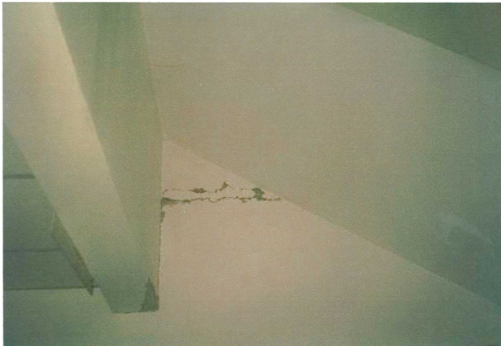
Foto 55: Daños en Escaleras.
