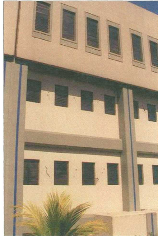
Foto 54: Daños en Pilares de Fachadas del Edificio.
