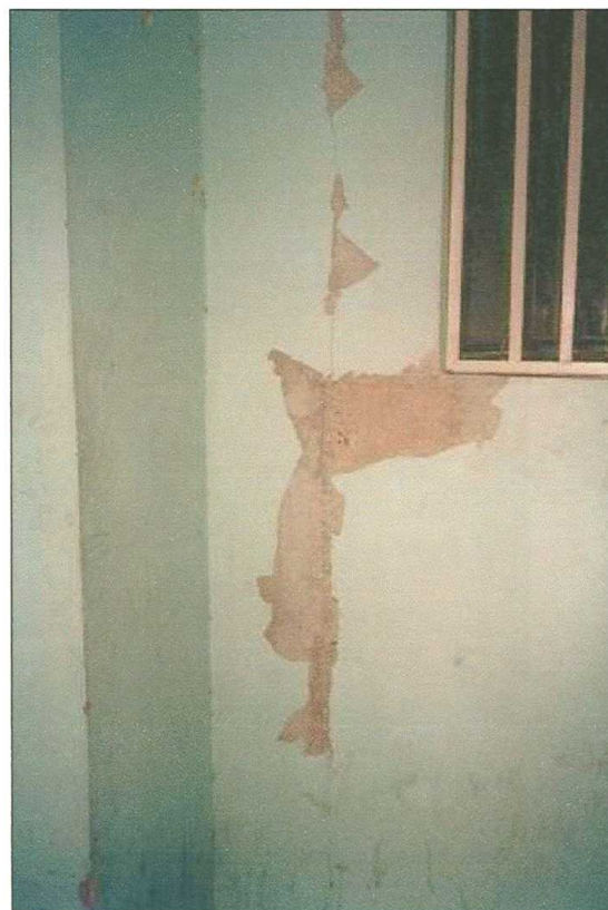
Foto 57: Daños en Encuentros de Muros con Pilar.
