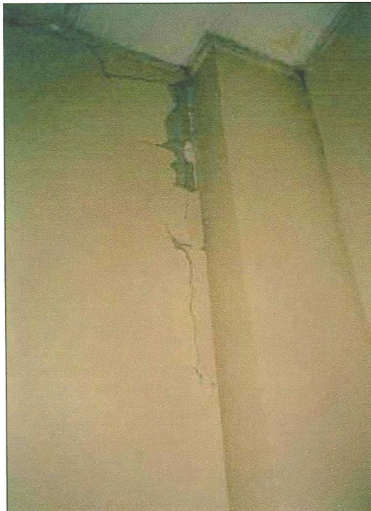
Foto 59: Desprendimiento de Repellos en Uniones Muro Pilar.
