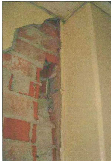
Foto 62: Daño Severo de Muro en Encuentro con Pilar.
