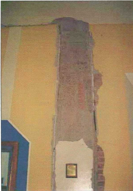
Foto 65: Caída de Repellos de Pilares
