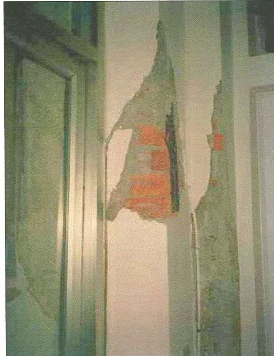
Foto 60: Daño Severo en Pilar no Estructural.
