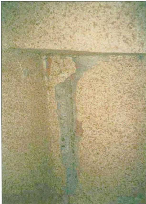
Foto 67: Daños en Muros de Caja Escala.
