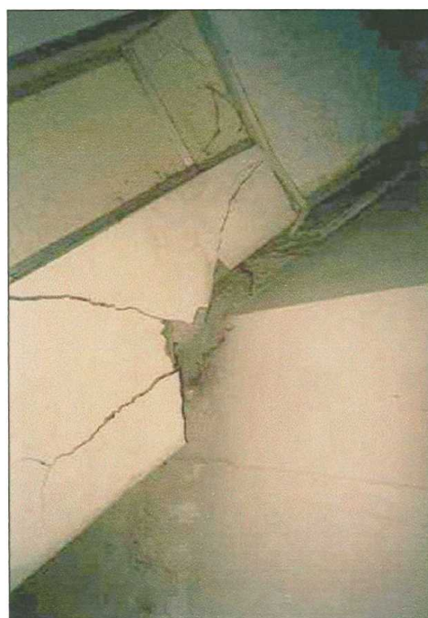
Foto 64: Daño no Estructural en Viga Antepecho.
