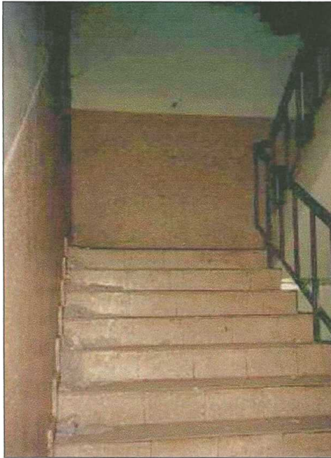
Foto 69: Daños en Muros de Caja Escala.
