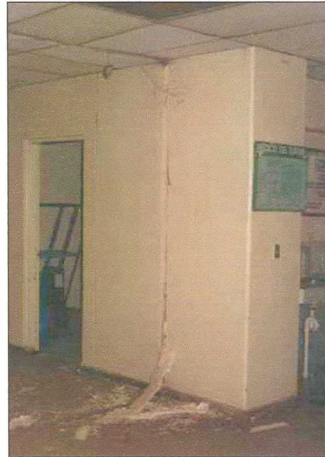
Foto 70: Daños en Junta de Dilatación.
