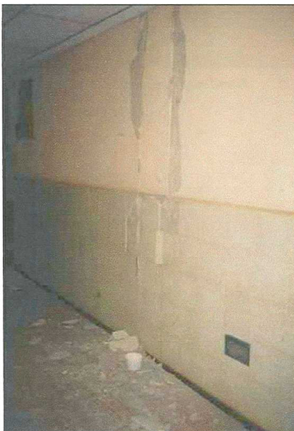
Foto 79: Daños en el Encuentro Muro Pilar.
