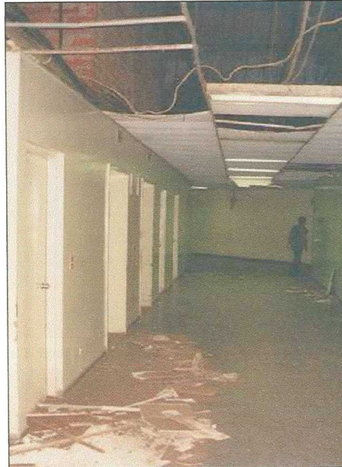
Foto 73: Daños en Cielos Falsos.
