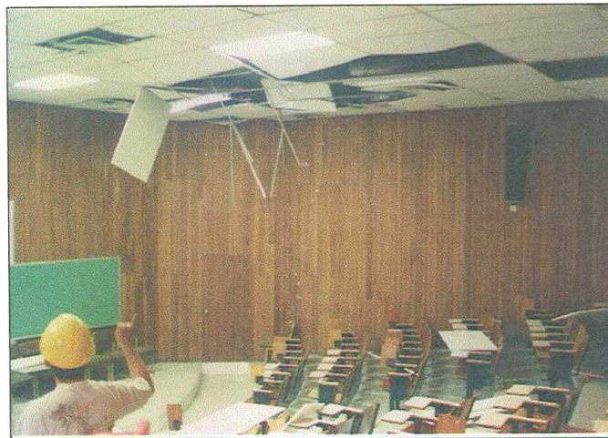
Foto 74: Daños en Cielos Falsos.
