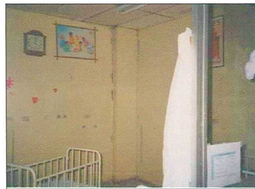
Foto 78: Daños en el Encuentro Muro Pilar.
