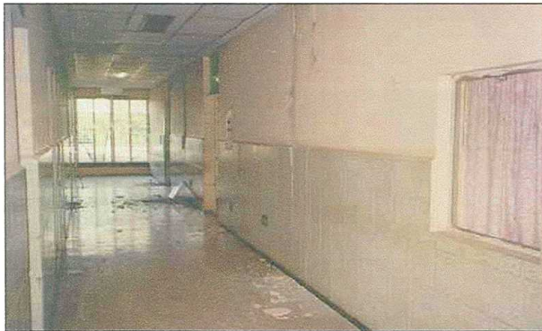
Foto 77: Daños en el Encuentro Muro Pilar.
