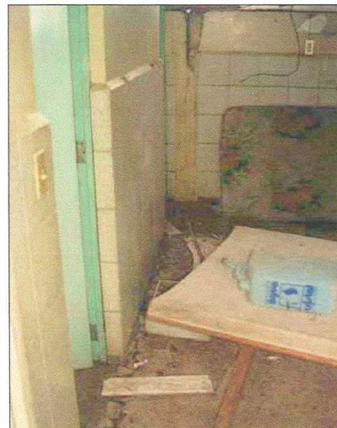
Foto 80: Daños en Junta de Dilatación.
