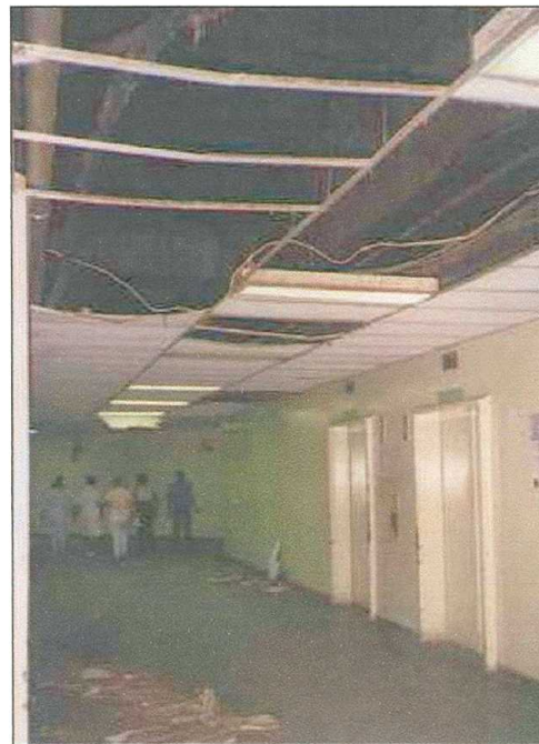
Foto 72. Daños en Cielos Falsos.
