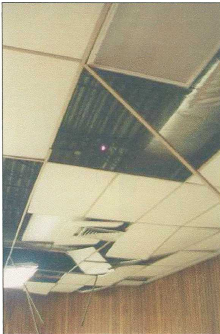
Foto 71. Daños en Cielos Falsos.
