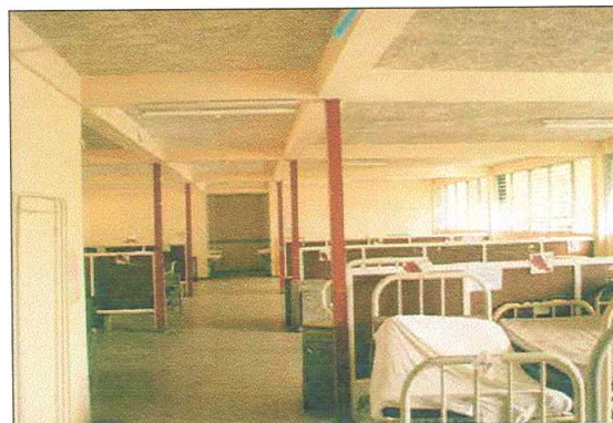
Foto 92: Losas Agrietada Edificio Lucha.
