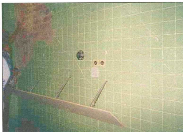
Foto 82. Colapso de Muros en Sector de Quirófanos.
