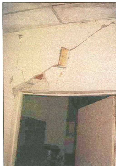
Foto 84: Daños en Vigas Dintel.
