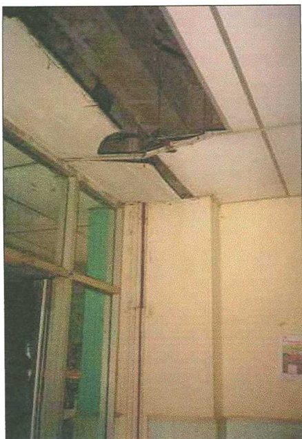
Foto 85. Daños en Junta de Dilatación.
