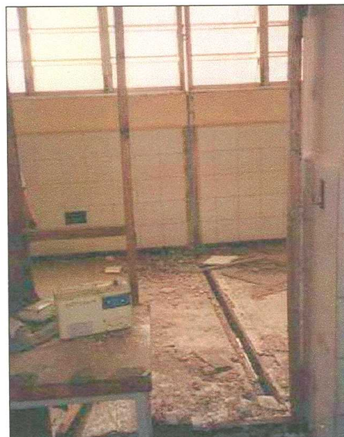
Foto 86: Daños en Junta de Dilatación.
