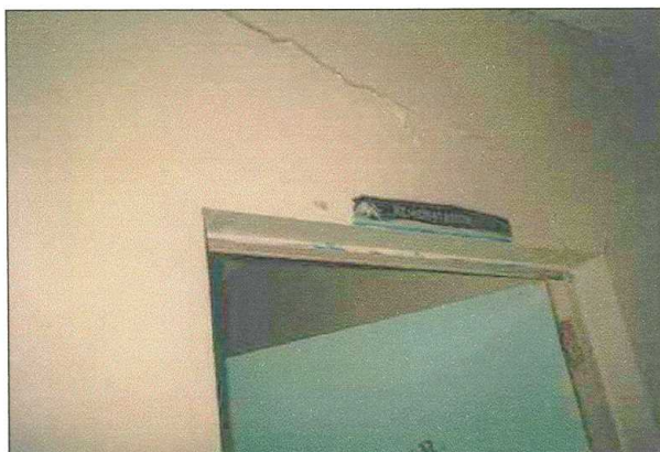
Foto 83: Daños en Vigas Dintel.
