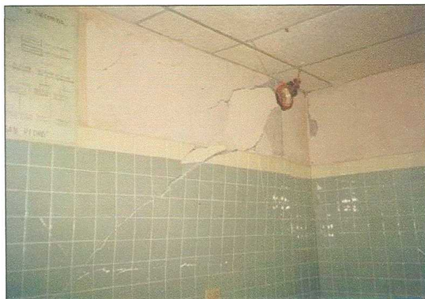
Foto 81. Colapso de Muros en Sector de Quirófanos.
