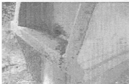
Foto 49: Corrosión. Puente La Balsa (Meta).
