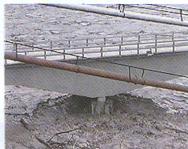
Puente Gumucio destruido por inundación en el Chapare - Cochabamba Fuente: DGAEA
