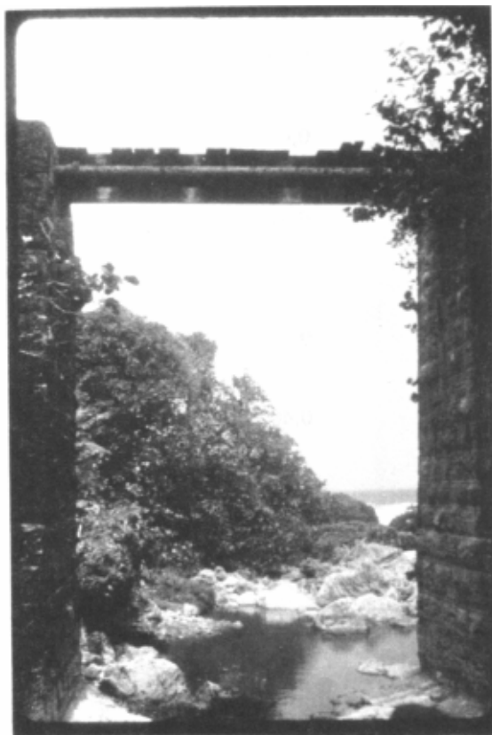
Los componentes vulnerables probablemente sufrirán daño estructural
