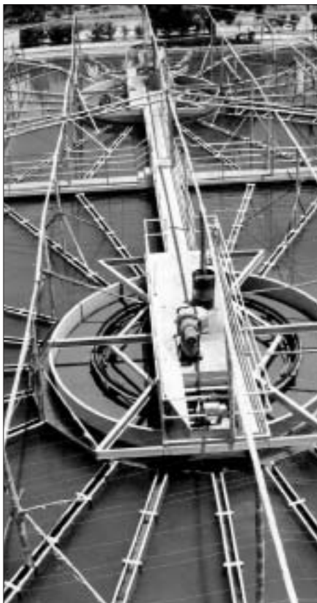
Medida de emergencia instalación de estructura para evitar caída de cenizas, protegiendo planta de tratamiento. Erupción Volcán Pichincha, Ecuador, 1999
