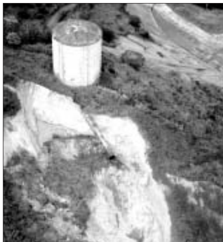
Deslizamiento en tanque de almacenamiento
