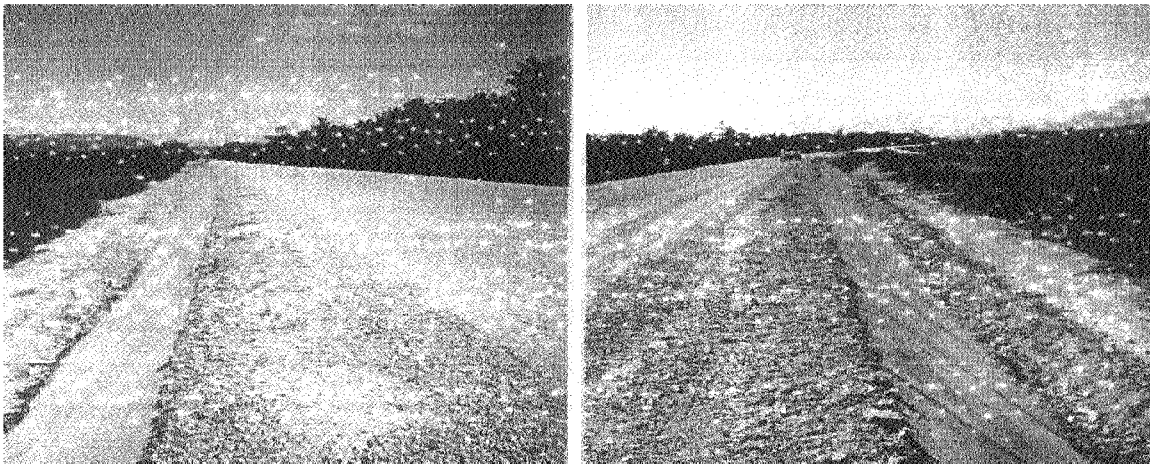
Fotos No.10 y No 11 Presencia de cunetas en un camino, con el fin de evitar el deterioro del mismo
